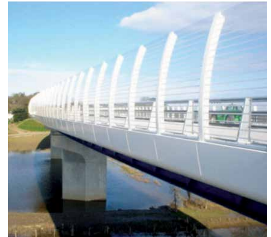
Photo 6 : Exemple d'écran acoustique doublé d'un équipement de retenue de niveau H2
